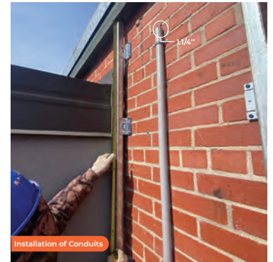
1 1/4" PVC electrical conduit.
