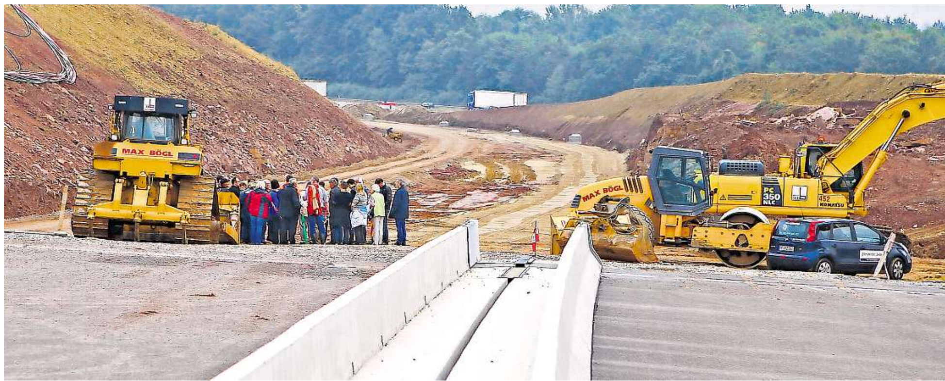
Die Brücke im Pfnztal ist fertig, der anschließende Ausbau bei Nöttingen läuft auf Hochtouren: Anwohner und Gemeinde, hier bei einer Begehung, kämpfen weiter für einen besseren Lärmschutz. FOTO: KETTER
