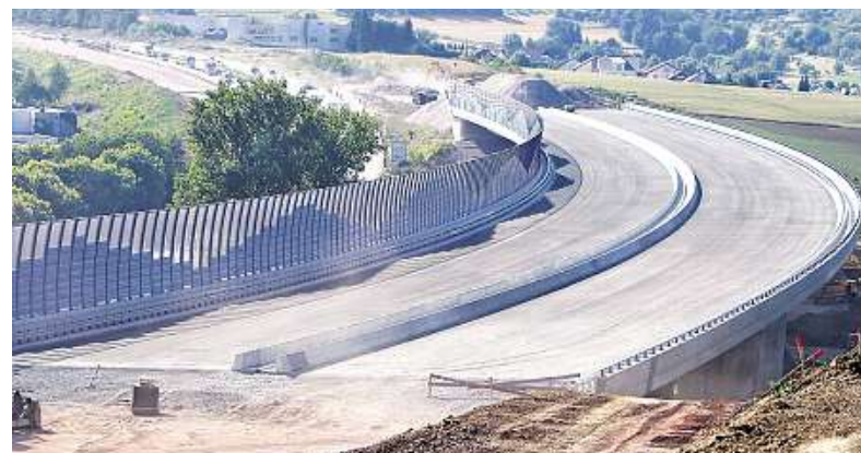
Die Anschlüsse bei der bereits fertigen Pfintalbrücke in Nöttingen werden gleichzeitig in Richtung Pforzheim und Karlsbad hergerichtet.
