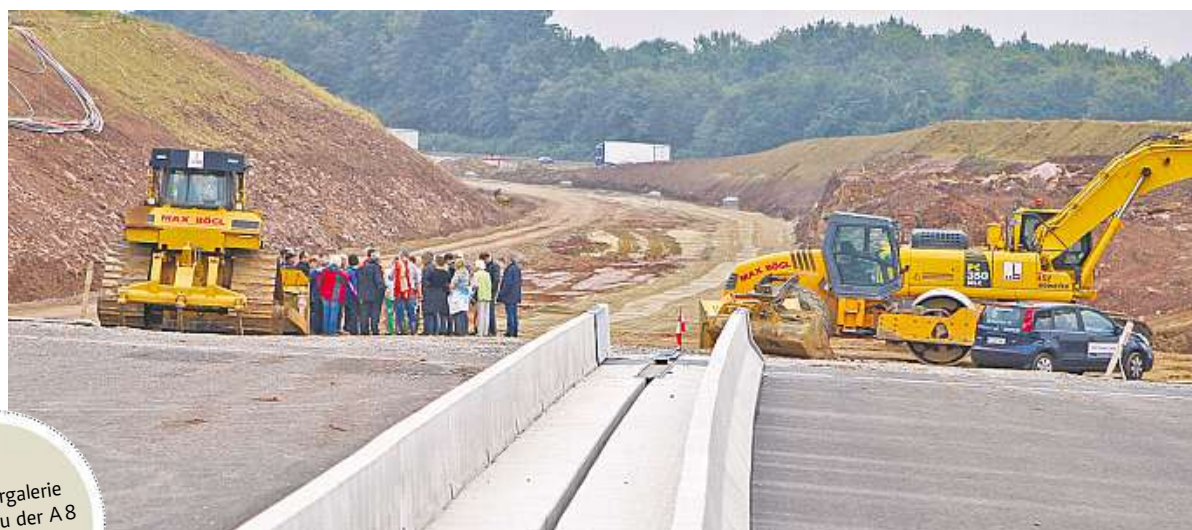
Ins Gelände geformt: die neue Trasse, die an die Fahrbahn Richtung Karlsruhe der Pfnitztalbrücke angebunden wird.
