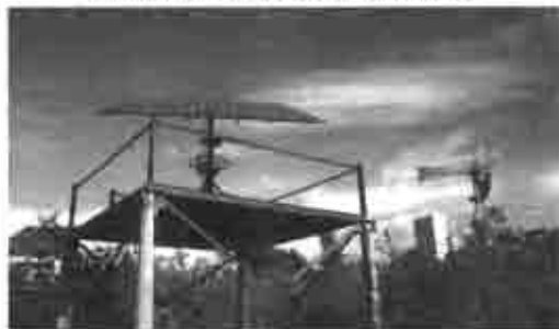
Paneles con seguidores solares para mejorar el rendimiento. Instalación conectada a red.
