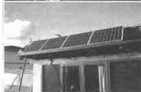
Pequeña instalación fotovoltaica para cubrir la iluminación de la casa. Sistema aislado de la red.
