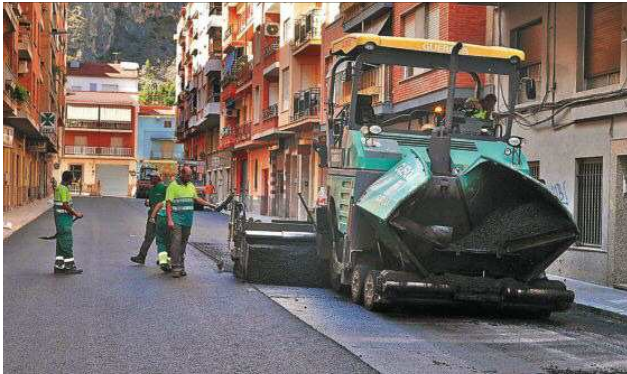
Una de las máquinas asfáltadoras en las que fue detectada la bacteria de la legionela. / CIO
