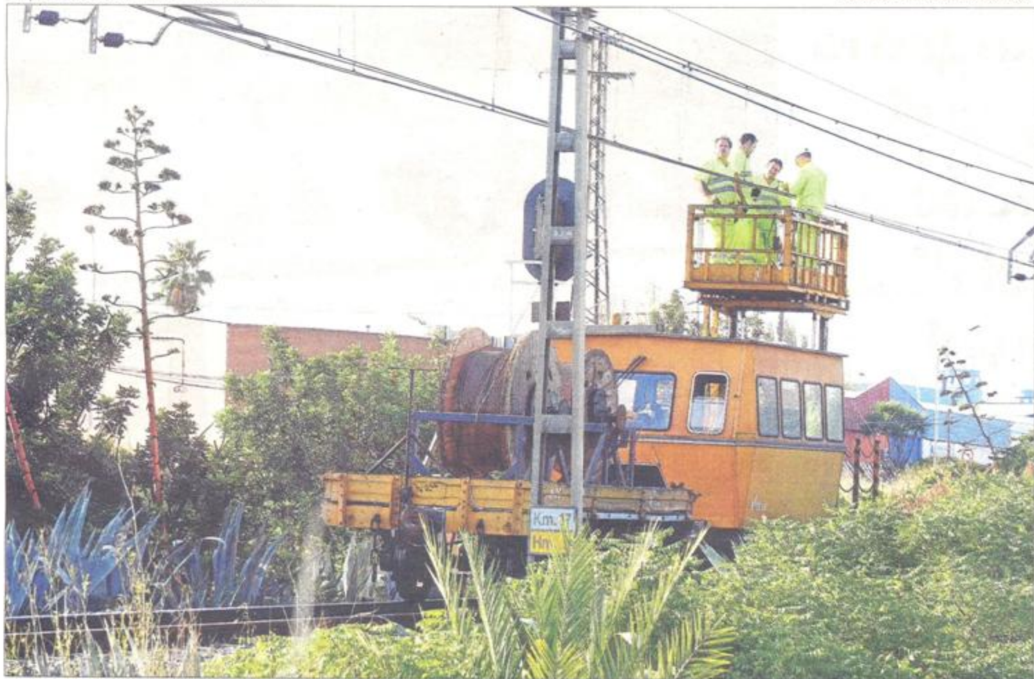
Operarios de FGV arreglan la avería que cortó el tramo comprendido entre la Canyada y Paterna durante 10 horas. M.A. MONTESINOS
